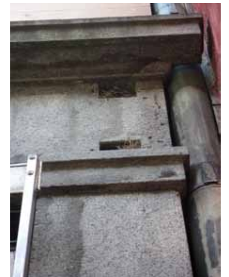
I bottenvåningen fanns bland annat hått efter infästningar och installationer. Foto Christer Kjellén
