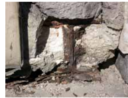
Bärande balk som bar upp burspråket med kraftiga rotskador. Det gick att plocka flagor med bara fingrarna. Foto Christer Kjellén
